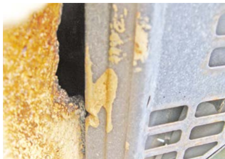
Obr. 18: Na přítomnost netopýřů v prostoru „vafek“ může poukázat hnědé zbarvení fasády.
